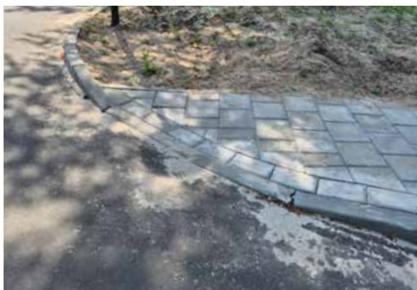
Berlagelaan fietstunnel niet haaks aangelegd
